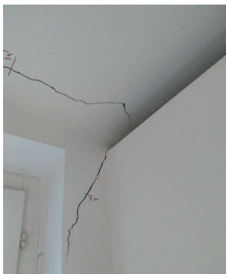
Im Nassräume-Bereich, Wandrisse bis über 2cm
