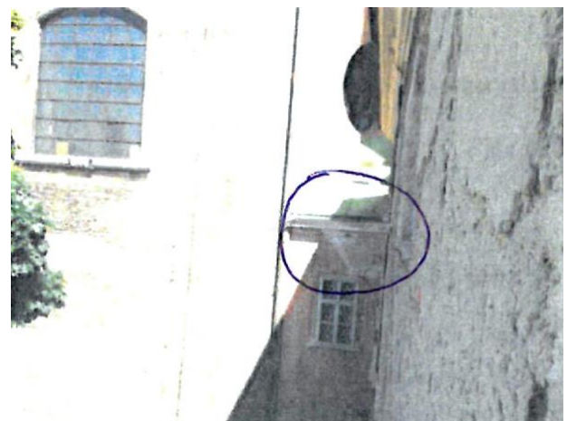
Schaden am Dach führte zu Schaden am Mauerwerk
