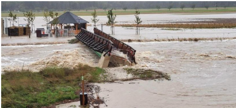
Die Brücke beim Überlaufbecken in Fahrafeld konnte den Wassermassen nicht standhalten.
