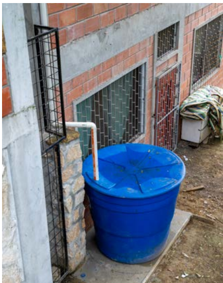
Mit Unterstützung aus Schwadorf wird Regenwasser gesammelt und für den Betrieb verwendet
